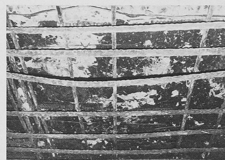
Bild 8. Unterseite Fahrbahnplatte Brandbereich
