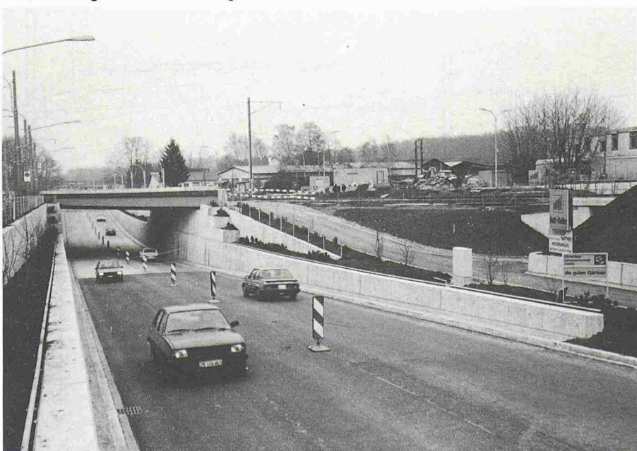
Bild 7. Unterführung im Betrieb. Am Bildrand rechts die separate Rad- und Fusswegunterführung. Foto D. J. Bänziger 13. 12. 86
